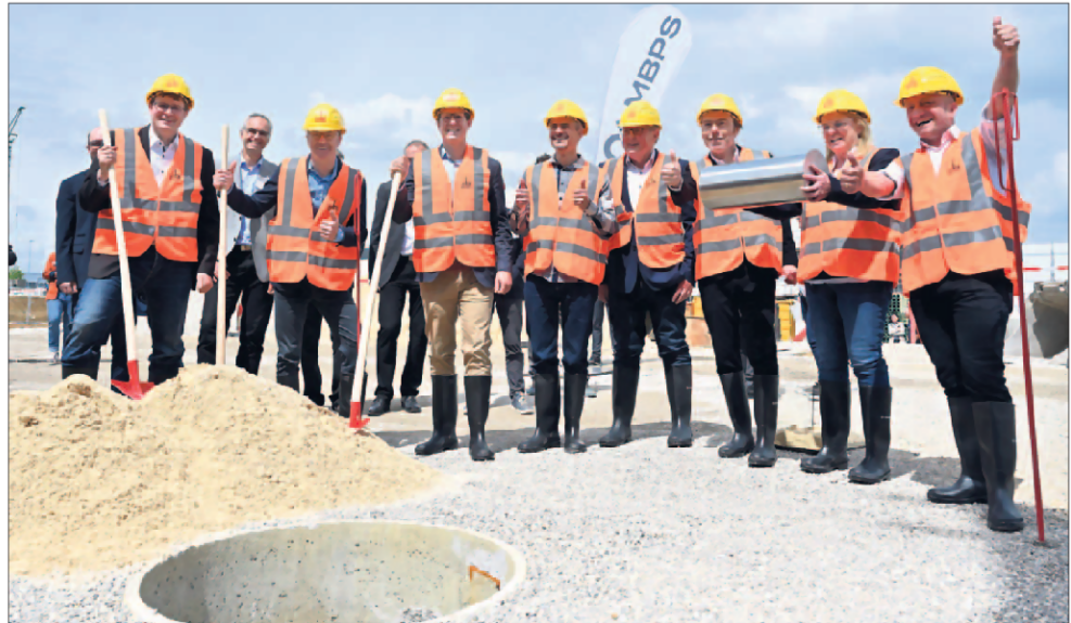
Grundsteinlegung für den künftigen Firmensitz von Magura Bosch Parts & Services (MBPS) in Nürtingen (mit Leuchtwesten, von links): MBPS-Geschäftsführer Jochen Hoppe, Claus Fleischer (Chef von Bosch E-Bike Systems), Nürtingens Oberbürgermeister Johannes Fridrich, Fabian Auch (geschäftsführender Gesellschafter Magenwirth Technologies Group), Hubert Schöllhorn (Großprojektleiter Max Bögl), Architekt Thomas Sonntag, MBPS-Geschäftsführerin Martina Class mit Zeitkapsel und Falk Scheuber (Robert Bosch GmbH). FOTO: PIETH
